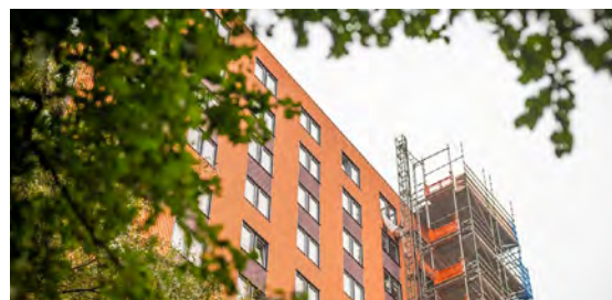
Lägenheterna i Medicinaren 12 får nya ledningar för el, vatten och avlopp samt att kök och badrum moderniseras.
